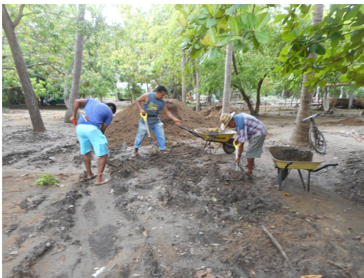
Arbete med att skyffla bort lera efter orkanen
